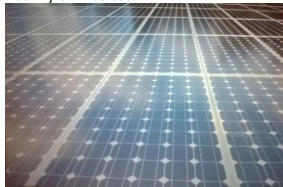
Zonnepanelen op het platte dak
